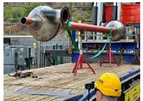
Anlage zur Energiegewinnung aus Abgasen in der Nähe von Heathrow/UK
